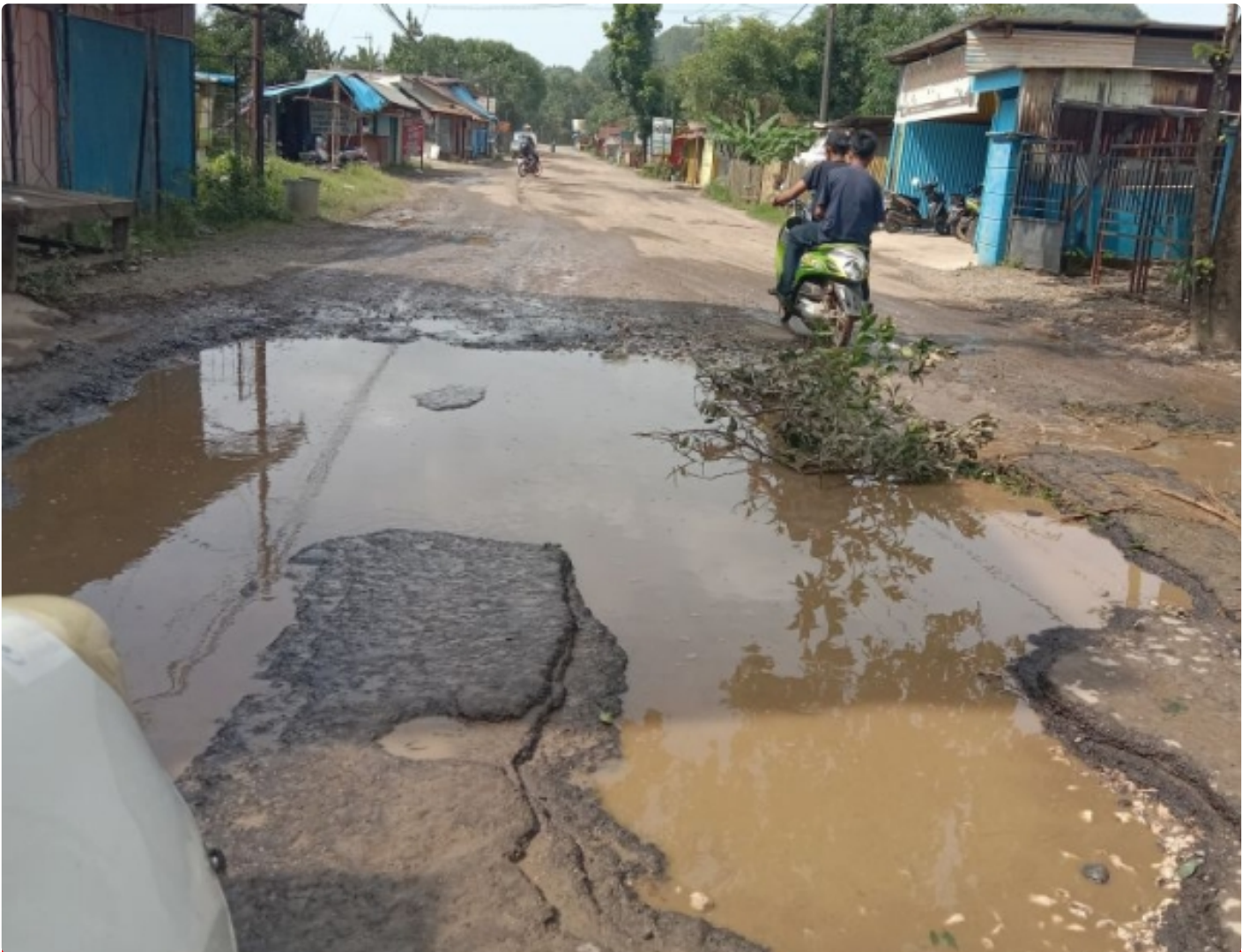
Jalan Minasate'ne rusak parah
